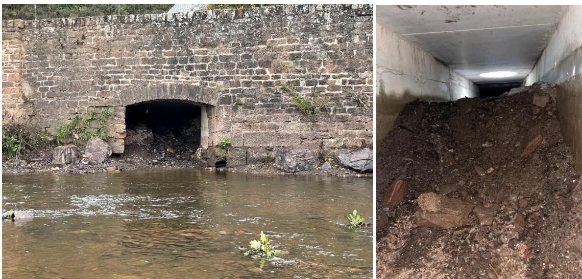
Abbildung 15: Mündungsbereich des Bärbaches in die Salm (links), Geröllansammlung im Bereich der Bachverrohrung (rechts).
