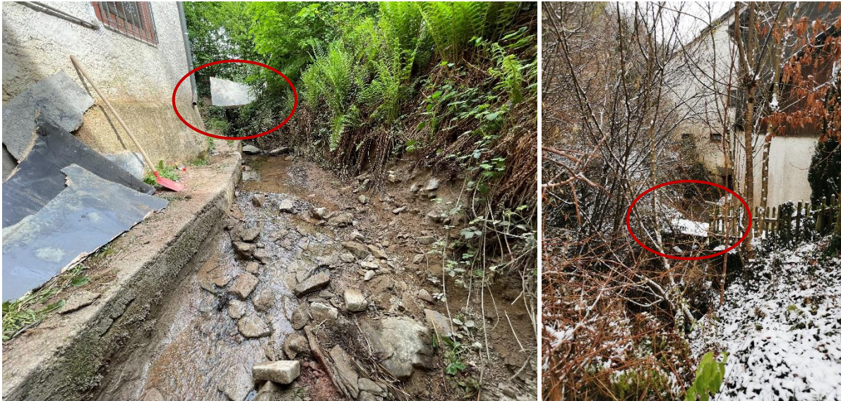
Abbildung 12: Private Fußbrücke über dem Bärbach (Gewässer III. Ordnung) als Abflusshindernis, Flur 11, Flurstück 17/1, Gemarkung Bruch.
