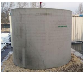
Abbildung 55 | Latentwärmespeicher IAB Weimar, 2025
