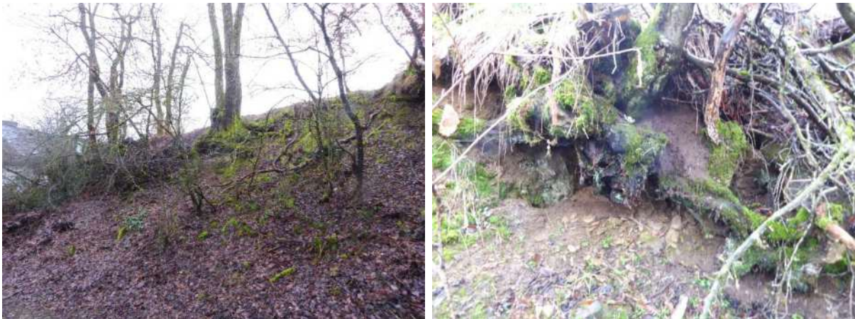
Abb.: Böschungsbereich hinter Häusern Abb.: Wurzelstock einer Hainbuche
